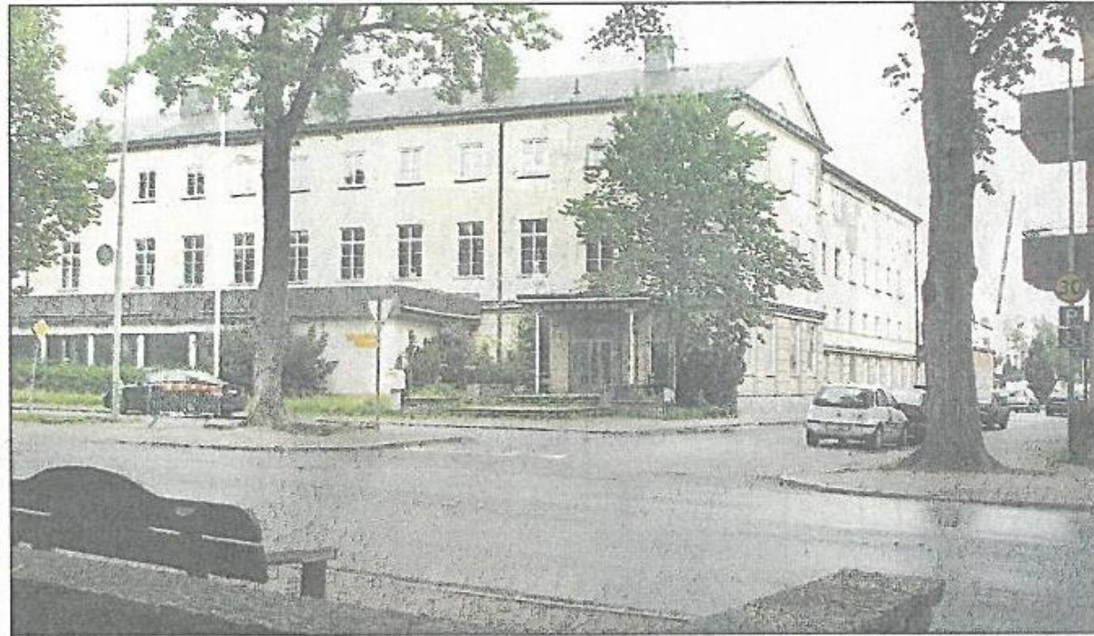
Stora Hotellet rivs. Snart. En gång en ståtlig byggnad men som nu är i kraftigt förfall. Går allt i lås river ägaren Skanska och bygger ett hyreshus åt Falköpings hyresbostäder AB.
